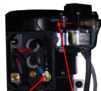
Cable batería negativo
